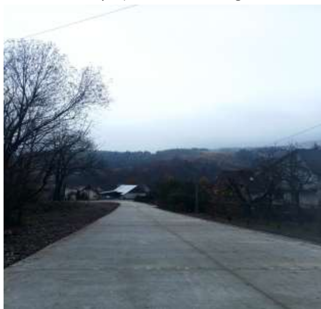
Remont drogi Kuźle (do Domów Wczasowych) w Szczawie, długość 120 mb - wartość 84 tys zł
